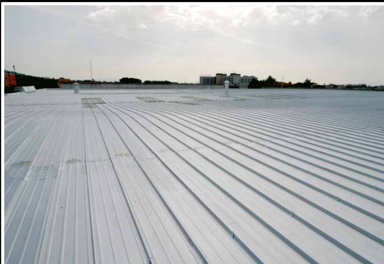
Aspetto della copertura metallica finita dopo il trattamento realizzato con una mano di vernice all'alluminio tipo Allumisol 12/14 steso dopo 20 giorni dalla seconda mano di ElastiK (applicazione a spruzzo con un consumo totale di 200 g/m 2 )
